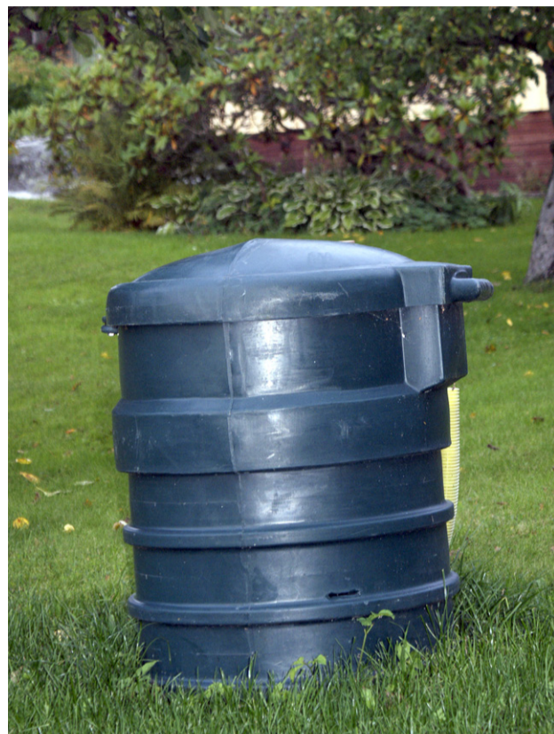
När Gällstaö fick kommunalt vatten och avlopp 2002 utfördes det med ett så kallat LTA-system där en pumpenhet placeras inne på fastigheten. Ett flertal fastighetsägare har haft problem med dessa pumpar och många har själva fått betala för reparationer och ny pump.
